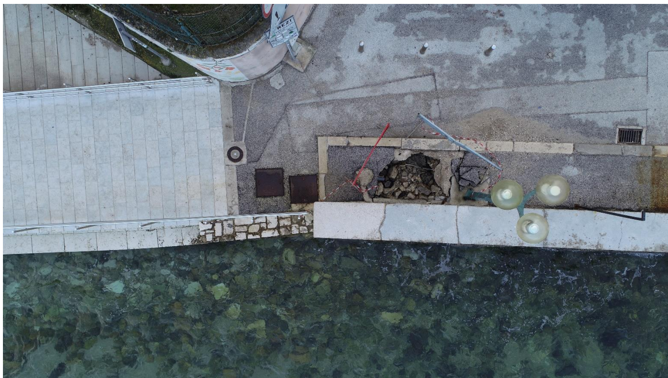
Slika 3. Pogled na oštećenje šetnice iz zraka
