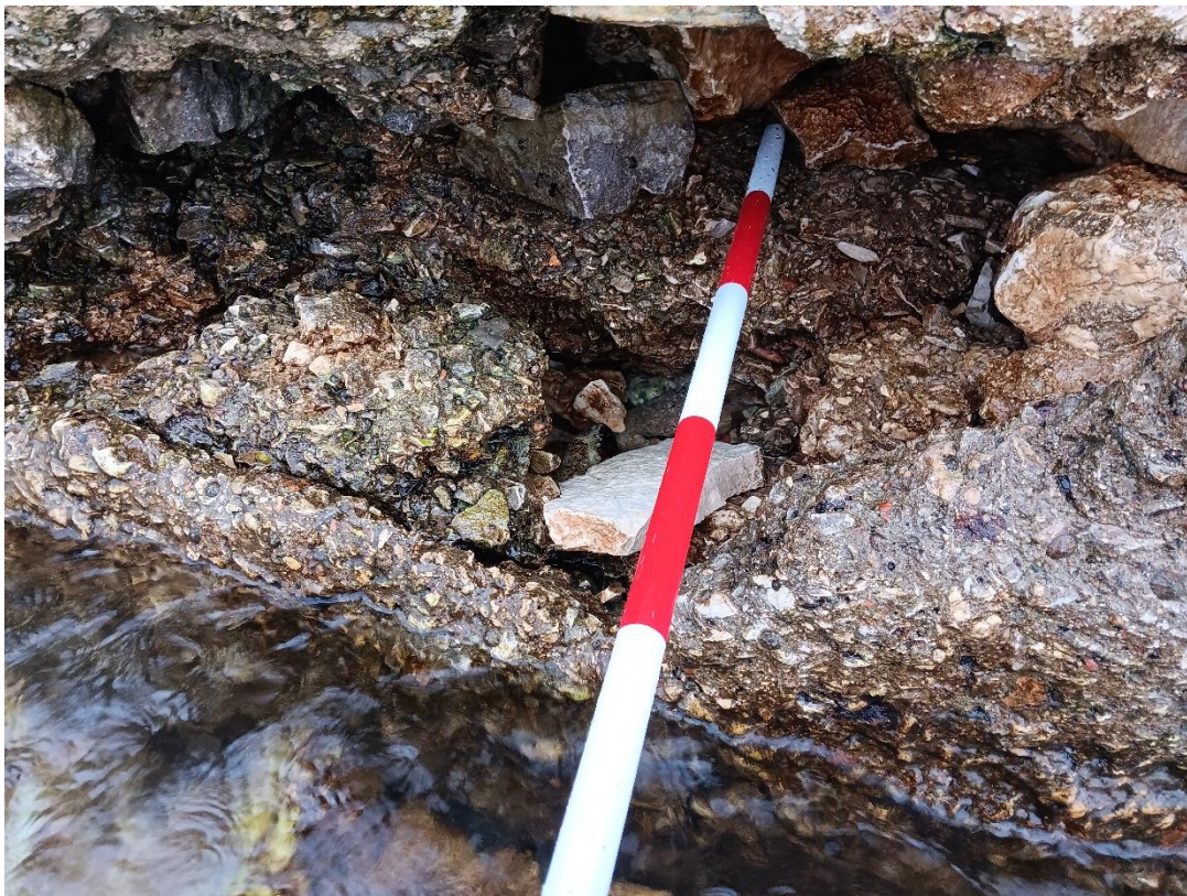
Slika 11. Pogled na podlokavanje na spoju betonskog temelje i kamenog zida (dubina rupe 60 – 80 cm)
