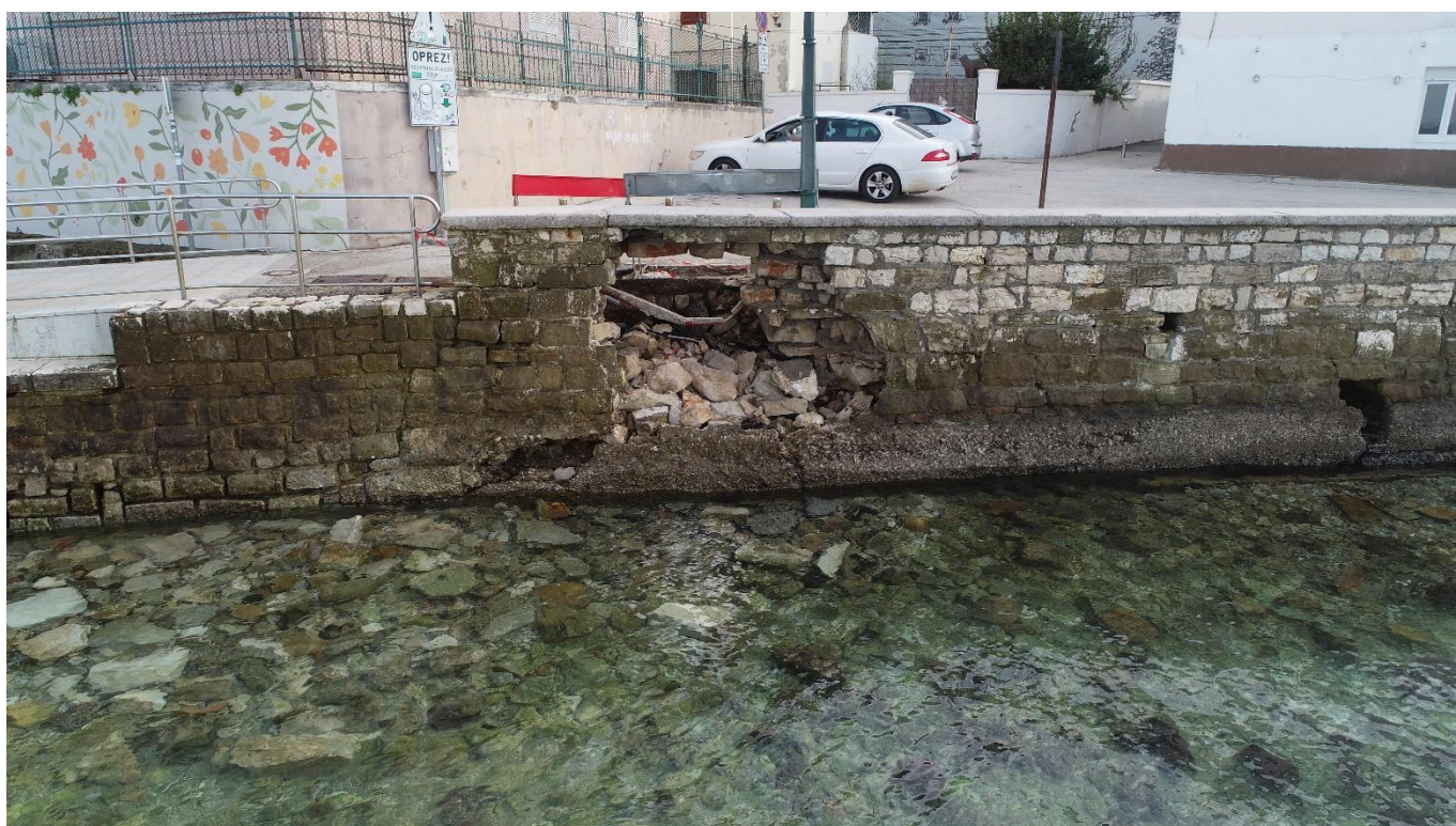
Slika 1. Pogled na oštećeni obalni zid iz zraka, sa strane mora
