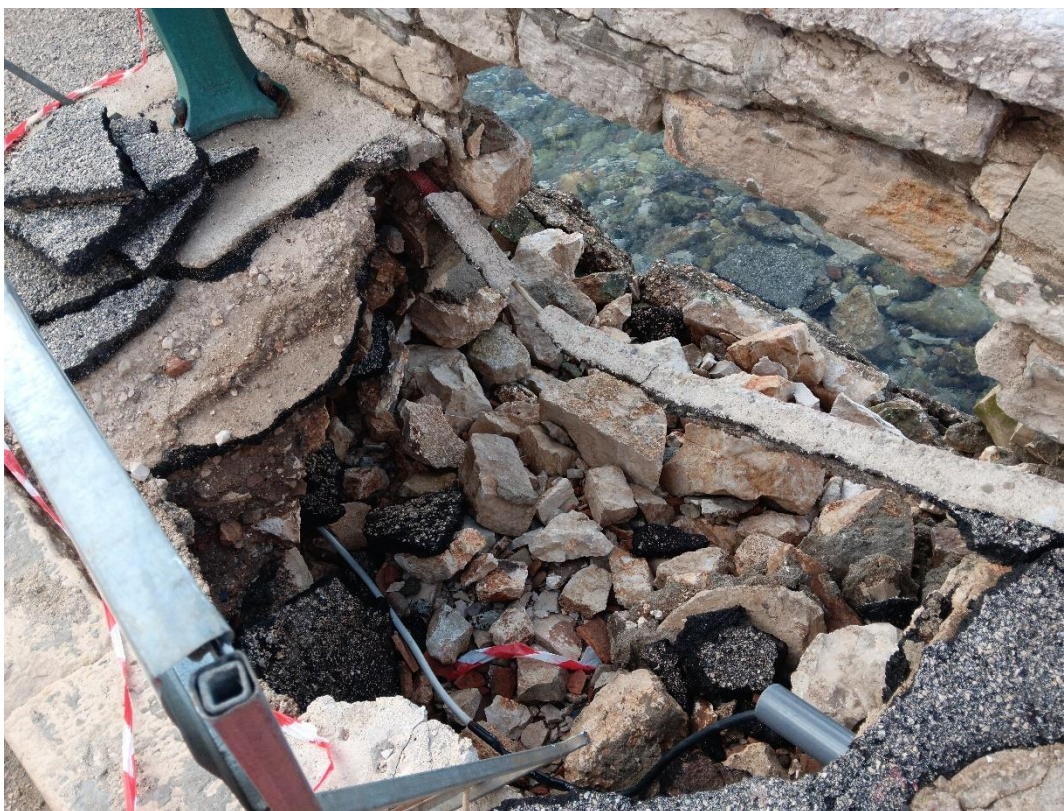
Slika 6. Pogled na oštećenje obalnog zida i šetnice (vidljivi kablovi el. energije)
