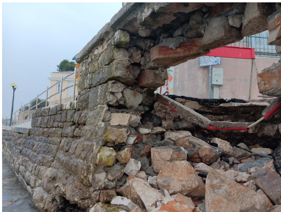
Slika 12. Pogled na urušeni obalni zid sa strane mora (vidljive el. instalacije)
