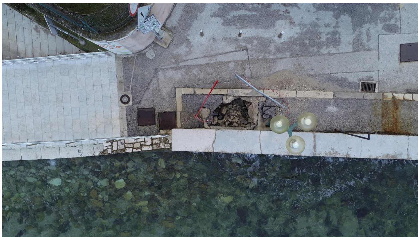
Slika 2. Pogled na oštećeni (urušeni) dio iza obalnog zida (šetnica)
