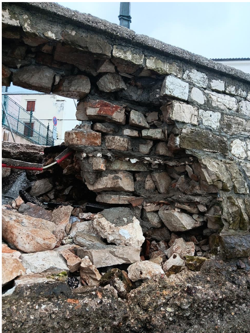
Slika 13. Pogled na urušeni obalni zid sa strane mora (vidljive el. instalacije)
