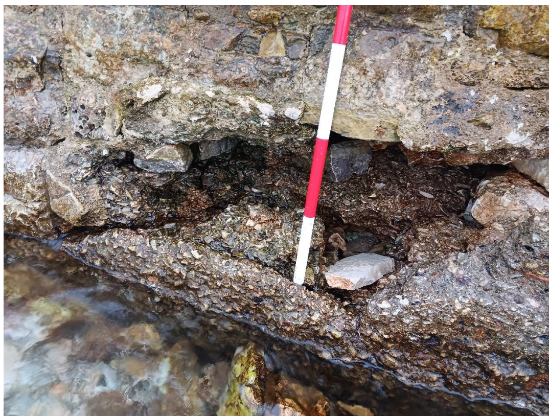
Slika 10. Pogled na podlokavanje na spoju betonskog temelja i kamenog zida (visina rupe cca 40 cm)
