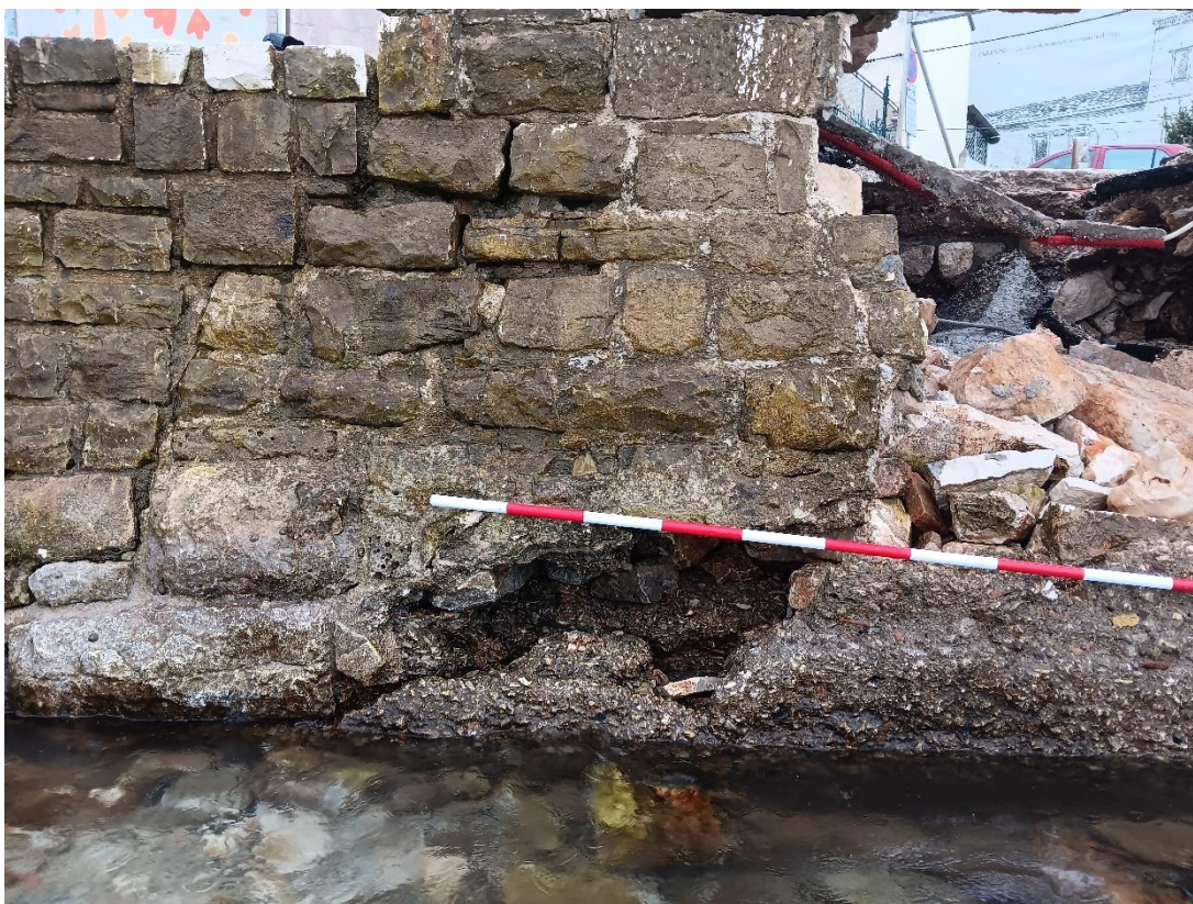
Slika 9. Pogled na podlokavanje na spoju betonskog temelja i kamenog zida (širina rupe cca 100 cm)
