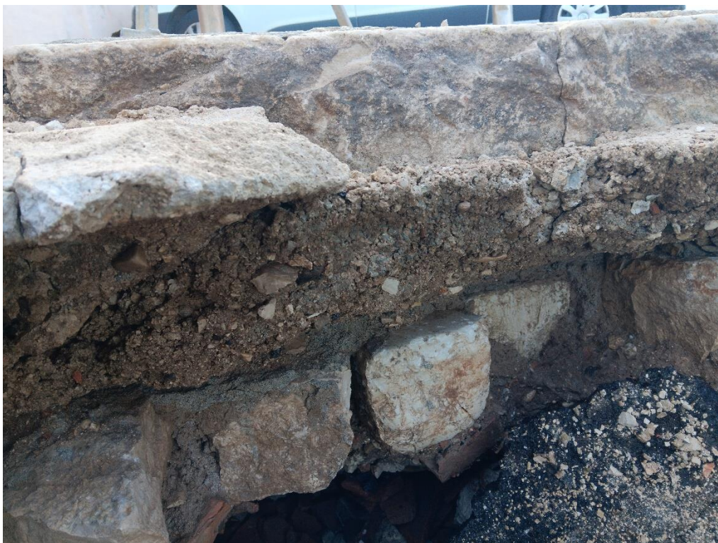
Slika 8. Pogled na slojeve materijala i rupu od podlokavanja ispod kamenih rubnjaka
