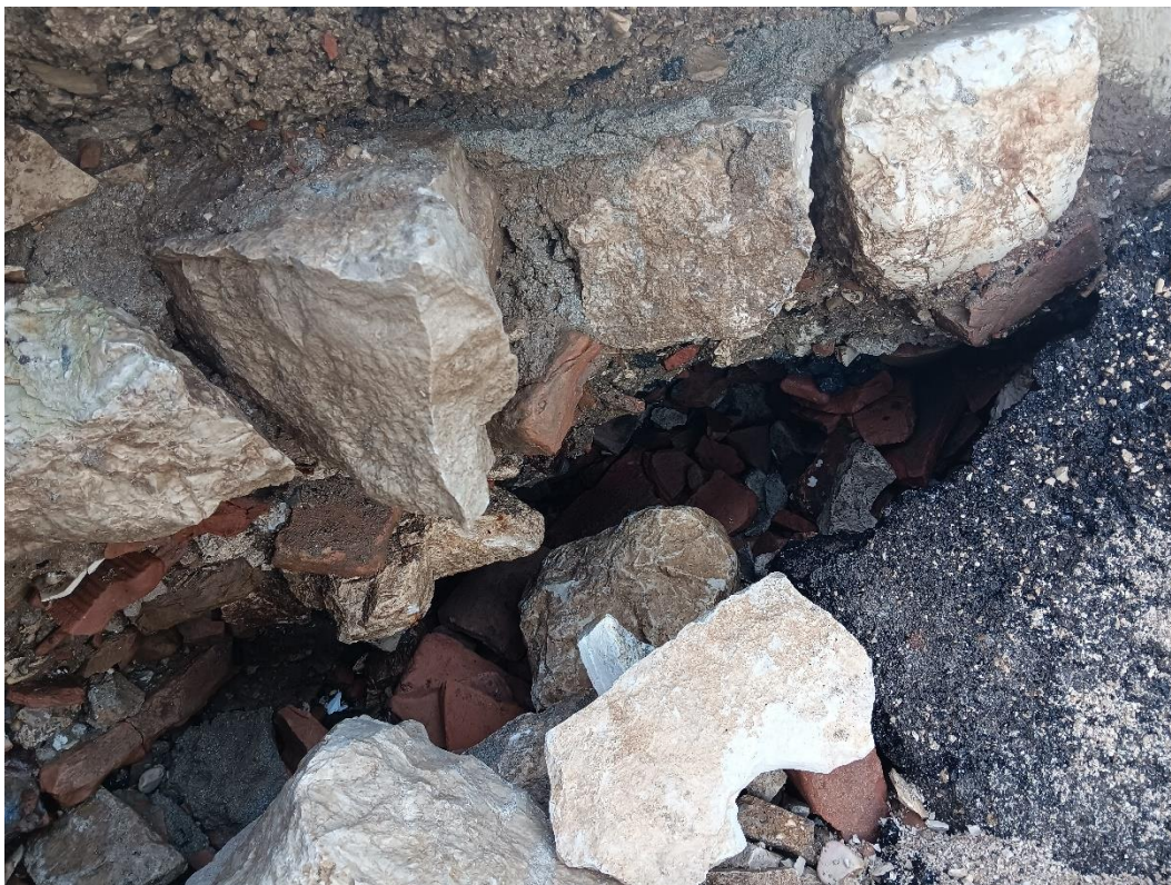
Slika 7. Pogled na podlokavanje ispod kamenih rubnjaka šetnice
