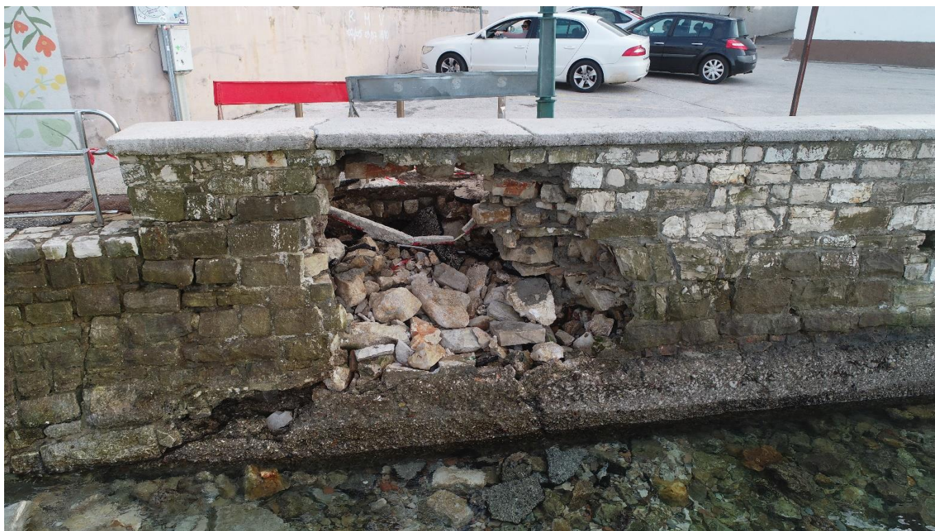
Slika 4. Pogled na oštećenje obalnog zida iz zraka
