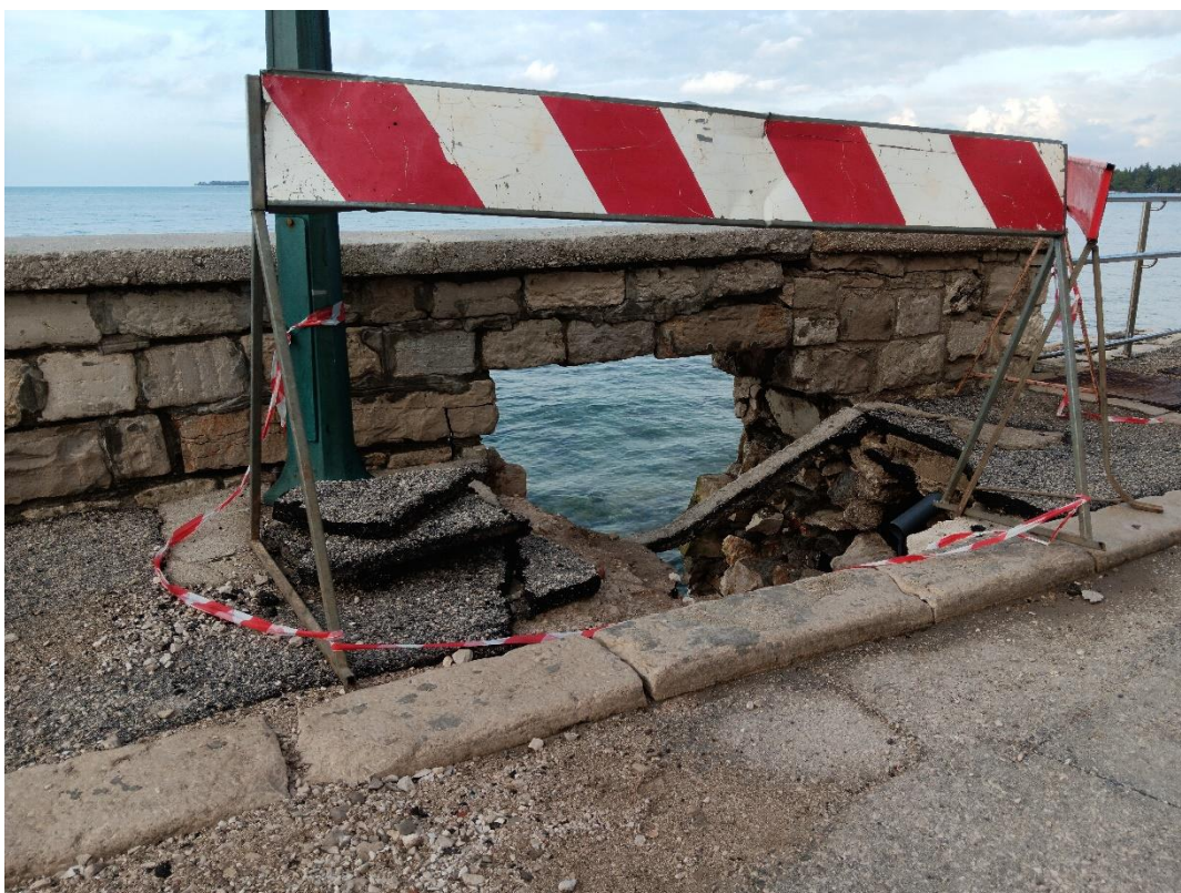
Slika 5. Pogled na oštećenje obalnog zida i šetnice (vidljivi kablovi el. Instalacija)
